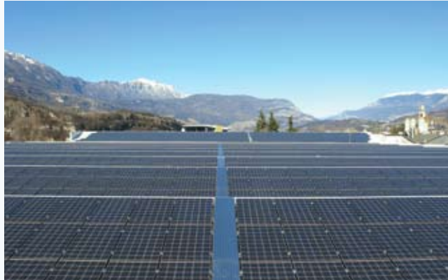
Impianto FV a Rovereto (Trento): Tecno Spot ha fornito il materiale e si è occupato dell'assistenza tecnica in fase progettuale.
