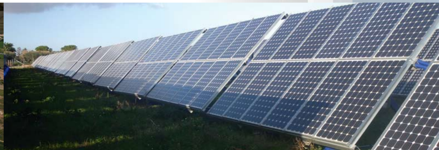
Progetto fotovoltaico da 4,3 MW realizzato con moduli CSUN in Puglia
