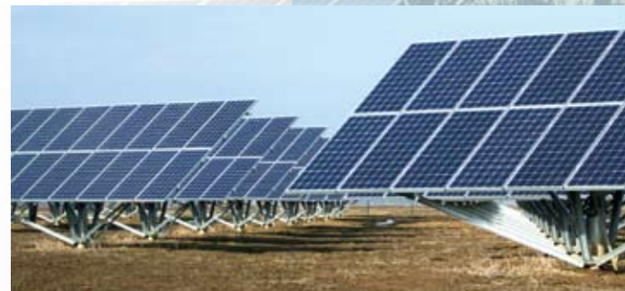
Impianto da 7,56 MW ad inseguimento con ST 25 di Ideematec a Torre Santa Susanna, Italia.
