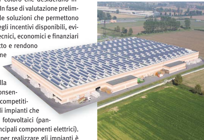
Impianto fotovoltaico sul tetto di un'attività commerciale (1.43 MWp) realizzato da Enerray a Martinego.
